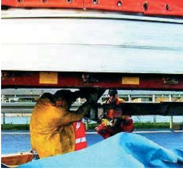
Abb. 37: So nicht! Fehlende Anstoßkappe bei Arbeiten unter Sattelanhängen
