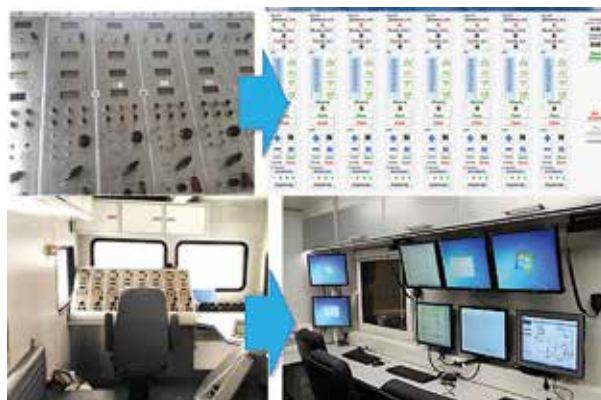
Рисунок 3 – Переход на системы управления Группы ФИД на примере станции контроля и управления
