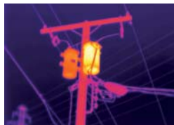
Přehřívání venkovních transformátorů
