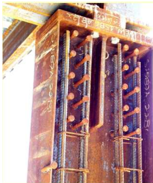
Fig.4.17 – Exemplo prático de uma zona de introdução de cargas com reforço por conectores [26]
