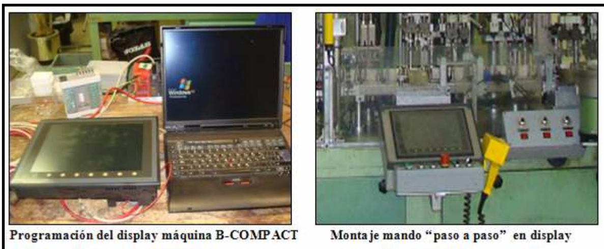
Fig. 5.17. Programación e instalación de mando acción manual.
