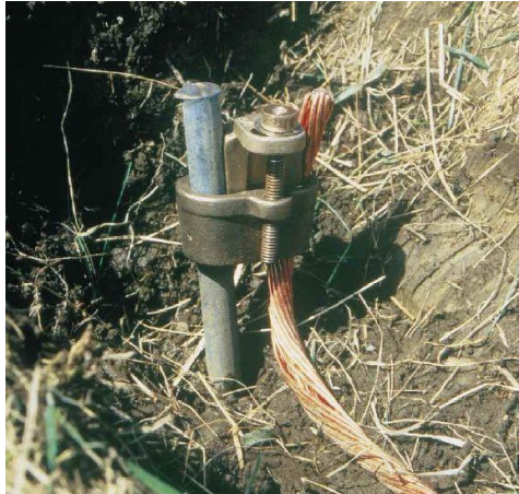
Gambar 6. Batang Pembumian ( Grounding )
