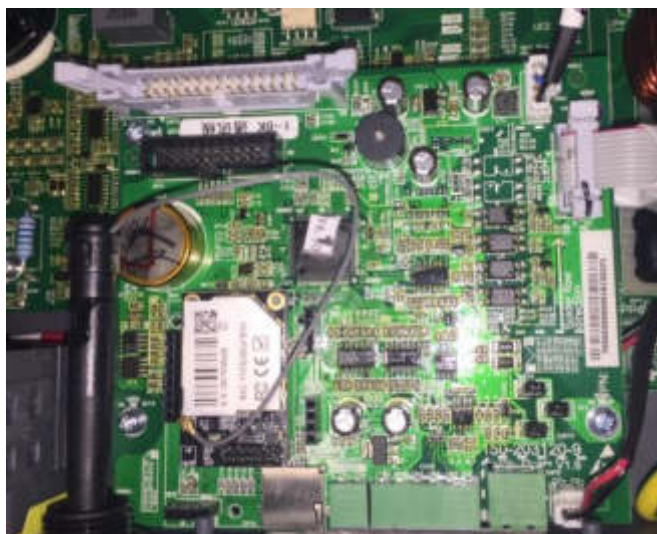
Figura 5 – Scheda wifi correttamente installata
