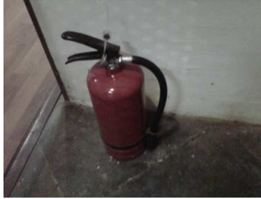
Gambar 2.6 Alat Pemadam Kebakaran (2)
