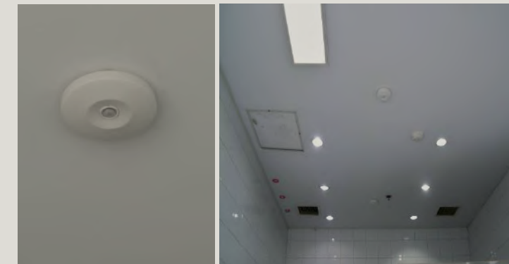
Gambar 3 Penggunaan Sensor Gerak pada Lampu Toilet Admin Building
