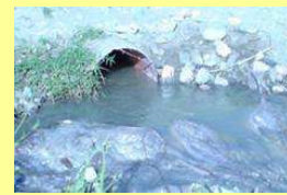
Vertido de aguas fecales directamente al mar.
