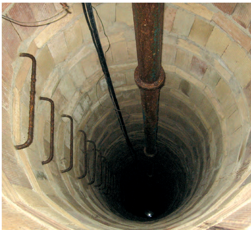
Interior de un pozo para regadío en el Altiplano. ED
