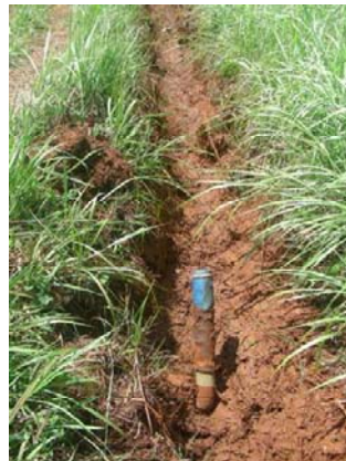
Canal vide Avec la prise d'eau d'un étang recouverte d'un manchon en filet
