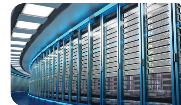
Trung tâm dữ liệu Data center
