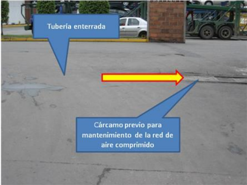
Fotografía 8. Tramo enterrado sin posibilidad de mantenimiento.
