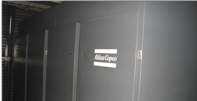
Fotografía 3. Compresor Atlas Copco ZR400 - SOFASA
