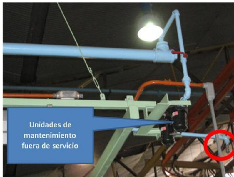
Fotografía 11. Unidades de mantenimiento fuera de servicio.
