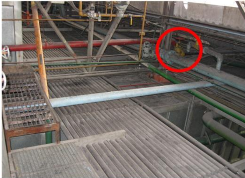
Fotografía 6. Válvula de paso inaccesible.
