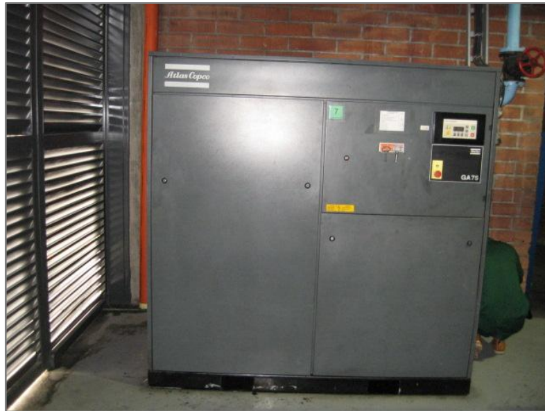
Fotografía 1. Compresor Atlas Copco GA75 - SOFASA
