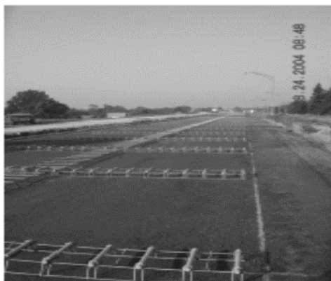
Gambar 21 - Ruji dan batang pengikat yang diletakkan dengan kokoh sebelum penghamparan dengan slip form
