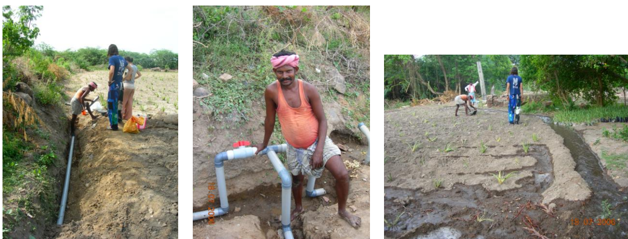
Figuras 38,39 y 40: Montaje sistema de riego de la parcela ALM1 y detalle de válvulas
