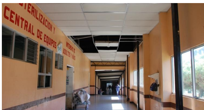
Figura 31. Daños a los cielos suspendidos del Hospital Nacional de San Marcos.
