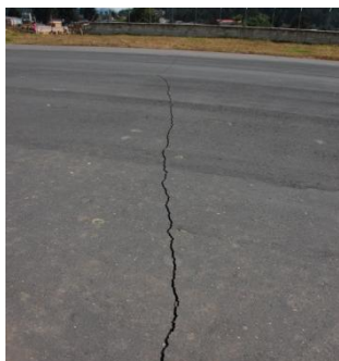
Figura 40. Grietas en la pista de aterrizaje del Aeropuerto de San Marcos.
