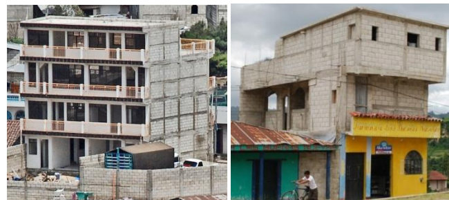
Figura 26. (a) Pequeño edificio de varios pisos construido de forma empírica en una ciudad en el occidente de Guatemala. Se observa las mismas características para las viviendas de dos pisos y, en este caso, la falta de paredes transversales. (b) Ejemplo de una configuración anormal de una vivienda de mampostería confinada.
