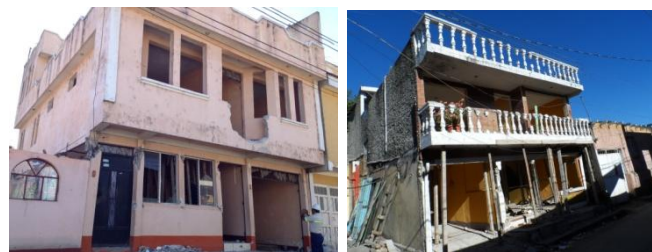
Figura 31. Configuración estructural inadecuada, típica estructura tipo "túnel".
