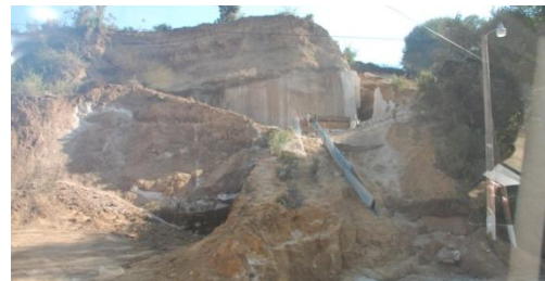
Figura 38. Daños a las pendientes de la carretera que une Quetzaltenango y San Marcos en la parte superior de San Juan Ostuncalco.
