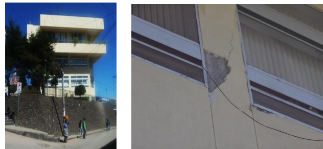
Figura 35. Edificio de tribunales en San Marcos. Sufrió serios daños debido a problemas causados por los efectos de torsión y columna corta.
