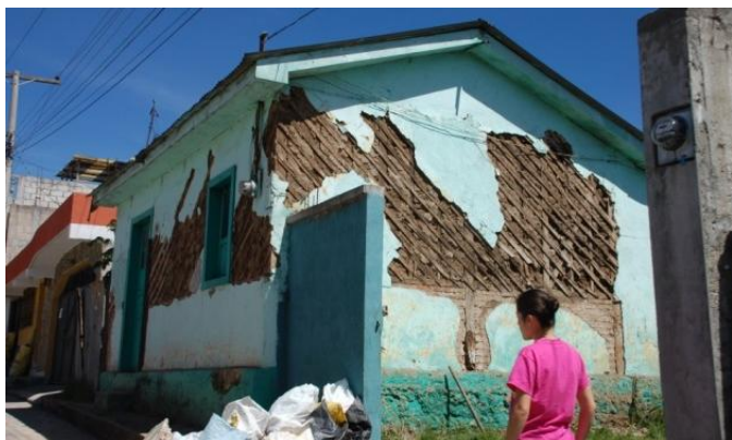
Figura 20. Estructuras en adobe (a) y bahareque (b) con daños severos
