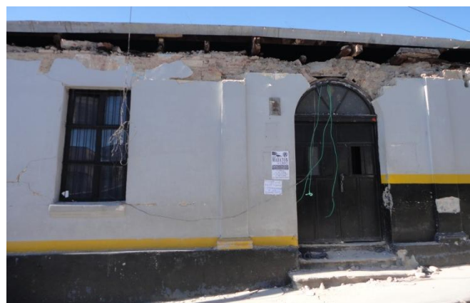
Figura 43. Daños en la estación de policía de San Marcos.
