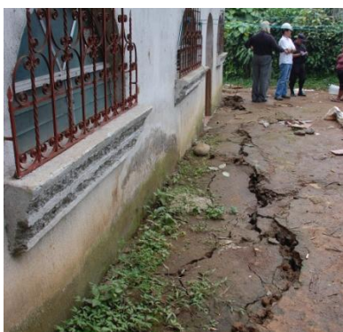
Figura 17. Sedimentación ocasionada por la licuefacción de la ribera de un riachuelo ubicado en la Municipalidad de Colomba, Coatepeque, Quetzaltenango.
