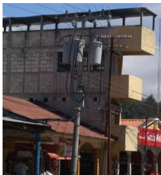
Figura 30. Configuración estructural inadecuada, típica estructura tipo "túnel".
