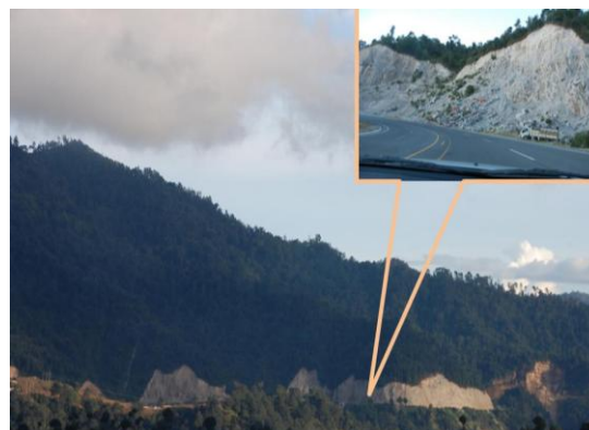
Figura 13. Deslizamientos ocasionados sobre la carretera CA-1 hasta Nahualá, kilómetros 148-152.5. La inestabilidad fue ocasionada en parte por el inapropiado diseño de los taludes de corte.
