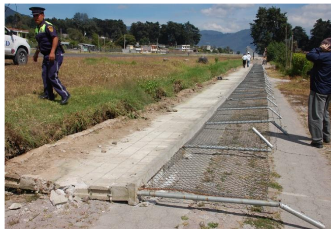
Figura 39. Daños a la pared perimetral del Aeropuerto de San Marcos.
