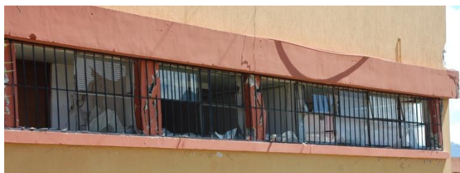
Figura 32. Daños en columnas en el Centro de Salud de San Pedro.
