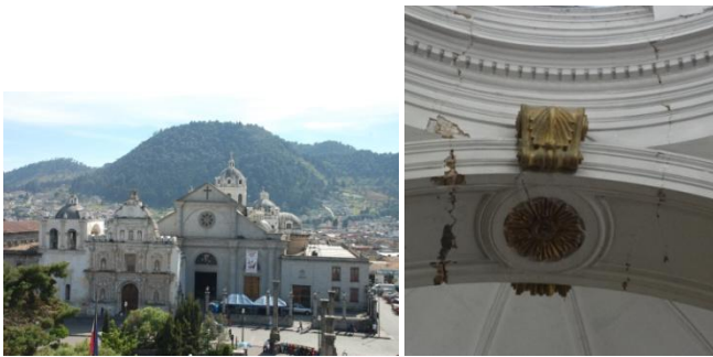
Figura 37. Daños registrados en la Catedral de Quetzaltenango.
