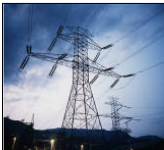
Líneas de alta tensión aéreas para transportar la electricidad.
