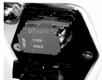
Kuva 19 – Vaihdetun varokkeen asento: kuvassa näkyy 115 voltin varoke
