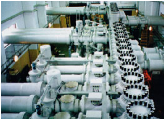
Zapouzdřená rozvodna Chodov
