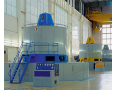
Strojovna vodní elektrárny Orlik
