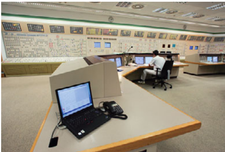
Velín Jaderné elektrárny Temelín
