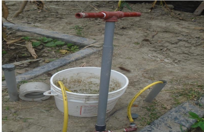
Figura 5. Bomba manual de extracción de agua drenada
