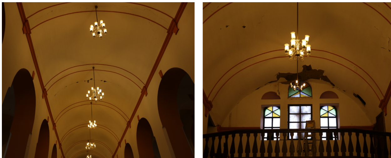
Figura 4: (Izquierda) Fisuras en la bóveda de la nave central de la iglesia de San Antonio de Pichincha. (Derecha) Caída del enchagllado en el coro (Foto: M. Perrault)
