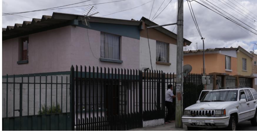
Figura 1: Viviendas tipo que presentan los mayores daños a nivel de mampostería (Foto: M. Perrault)
