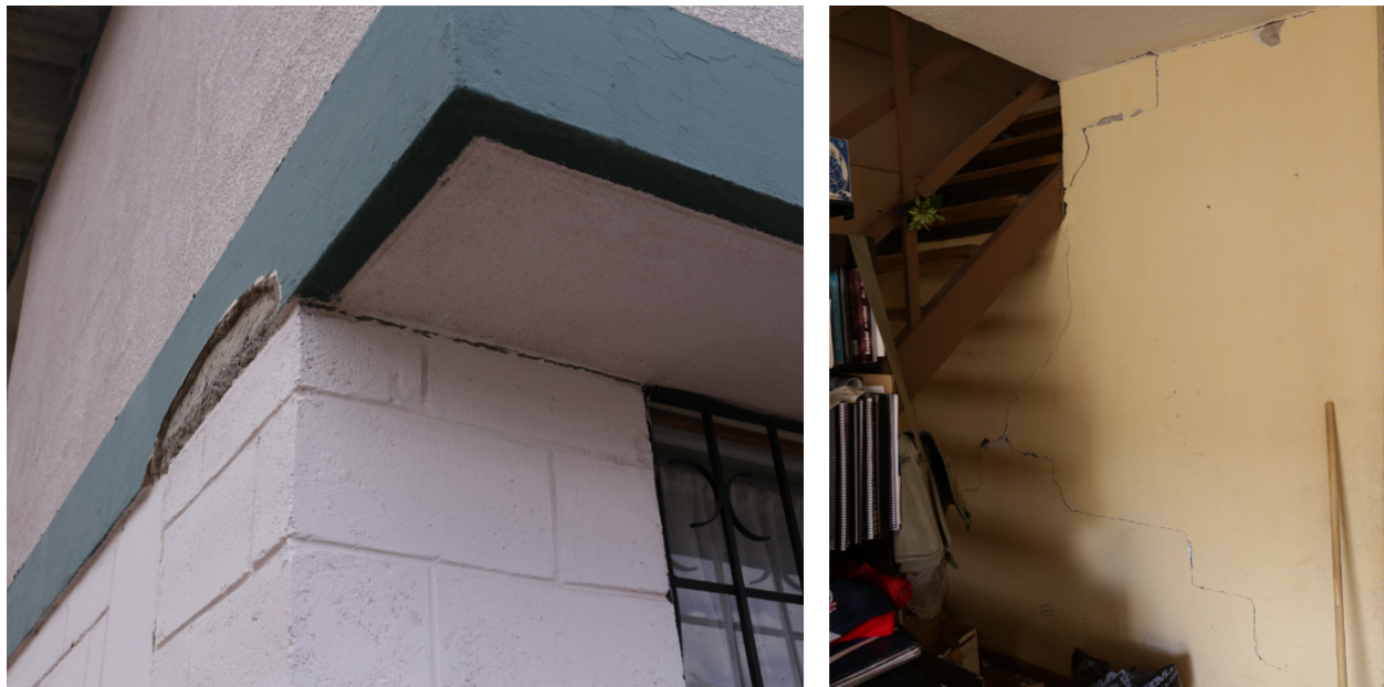
Figura 2: (Izquierda) Fisuras típicas observadas en las viviendas investigadas. (Derecha) Grietas a 45° en paredes no confinadas (Foto: M. Perrault)
