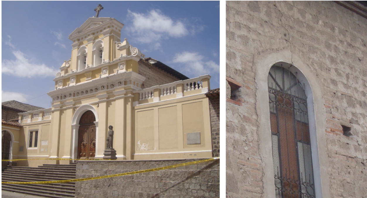
Figura 3: (Izquierda) Iglesia de Pomasqui, se observa la cruz fuera de plomo. (Derecha) Fisura que traspasa la pared lateral de la iglesia
