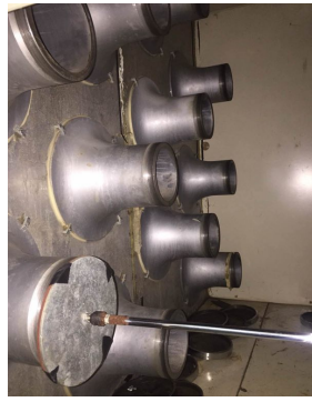
(d) Nozzles for air flow measurement
