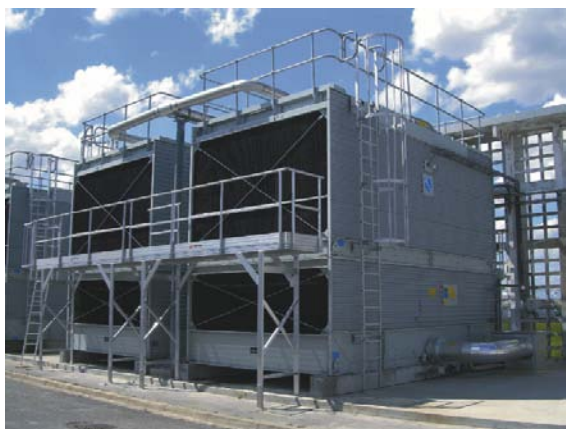
Enfriador evaporativo en industria minera.
