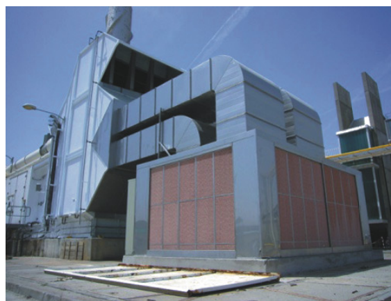
Condensador enfriador evaporativo en industria alimentaria.
