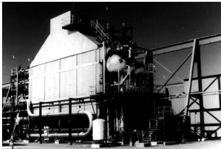
Figure 25. Forced-circulation HRSG with PG7111EA gas turbines
