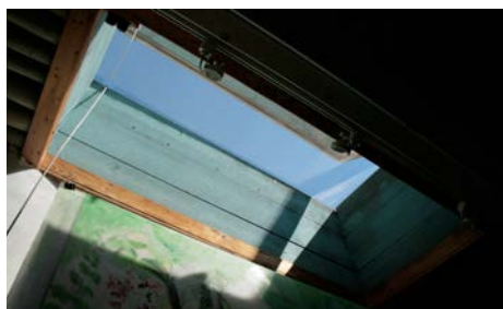
Absence de grillage au lanterneau
