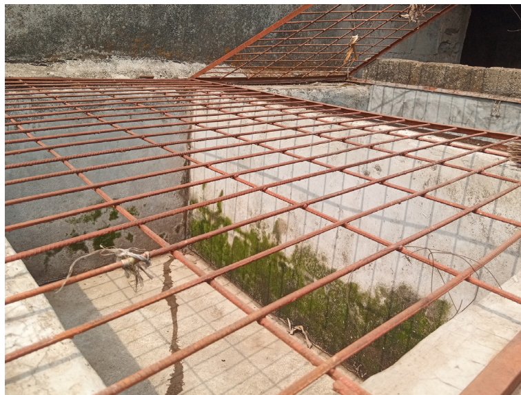
Figure 32 - Mauvais entretien de bac de rouissage : Fissures et développement des adventices dans le bac du rouissage
