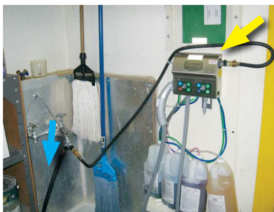
Figure 68 - Vue d'ensemble de la cuve de conciergerie Source : CMMTQ.
