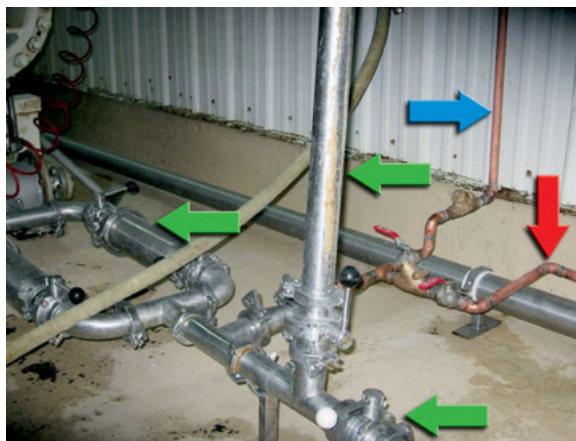
Figure 89 - Installation améliorée Source : CMMTQ.
