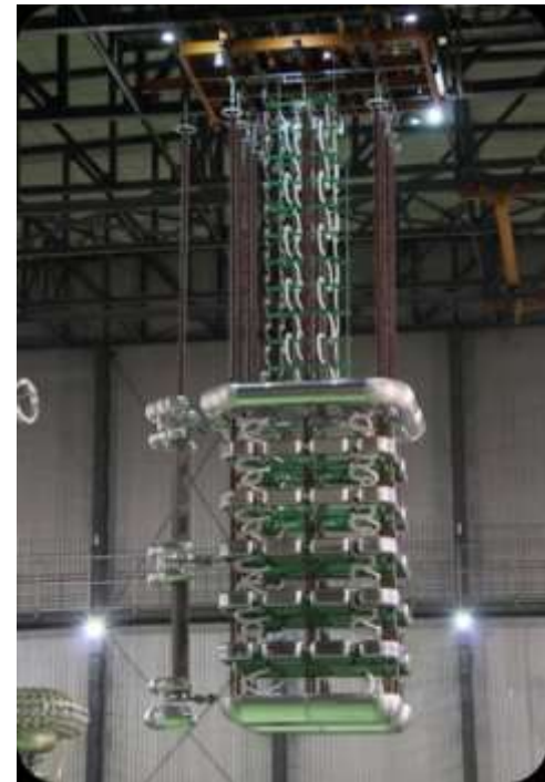
\pm 1100\text{kV} UHVDC valve
