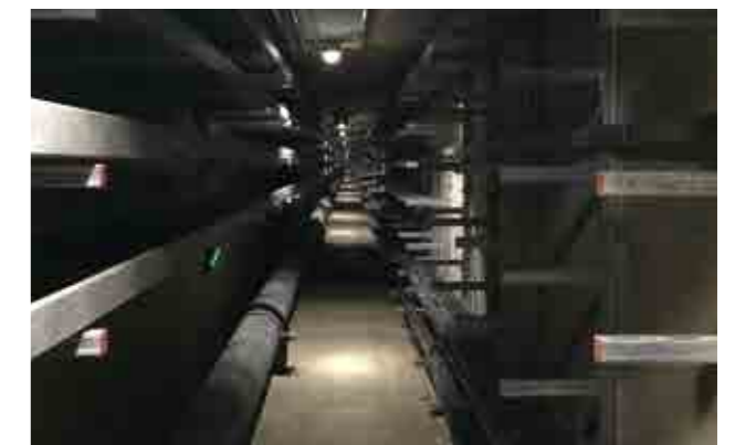
武汉王家墩管廊
