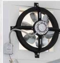
Exhaust Fan / inside view
