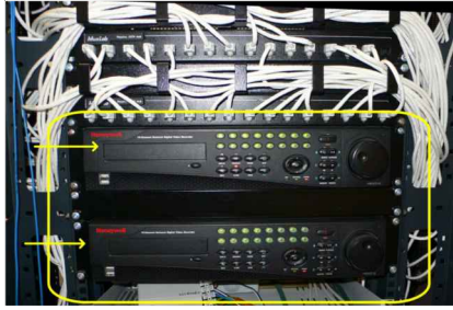
FOTO EJEMPLO DISTRIBUCION GRAVADORES CCTV EN RACK CENTRAL "R0" EN INTERIOR DEL RITU
