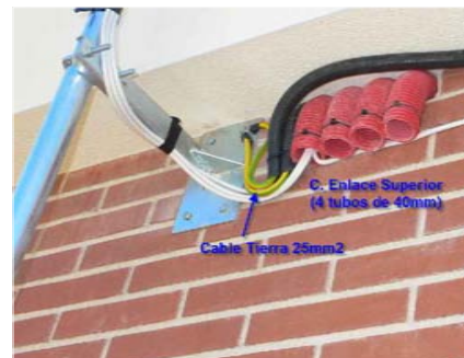
FOTO EJEMPLO TOMA DE TIERRA 25mm²
