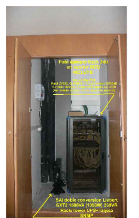
FOTO EJEMPLO DETALLE CCD RACK 19" A800, F800, 24U PARA UBICAR EN RITU (SALA TECNICA)
