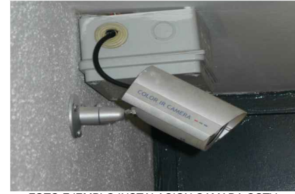
FOTO EJEMPLO INSTALACION CAMARA CCTV JUNTO EN CAJA PVC 160x160 PARA INTERCONEXIONADO ELECTRONICO Y FUENTE ALIMENTACION DE LA CAMARA
