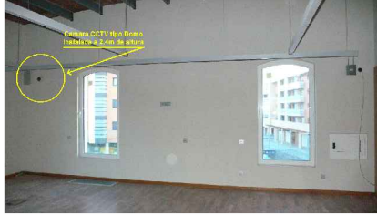
FOTO EJEMPLO INSTALACION CAMARA DOMO EN INTERIOR SALA POLIVALENTE
