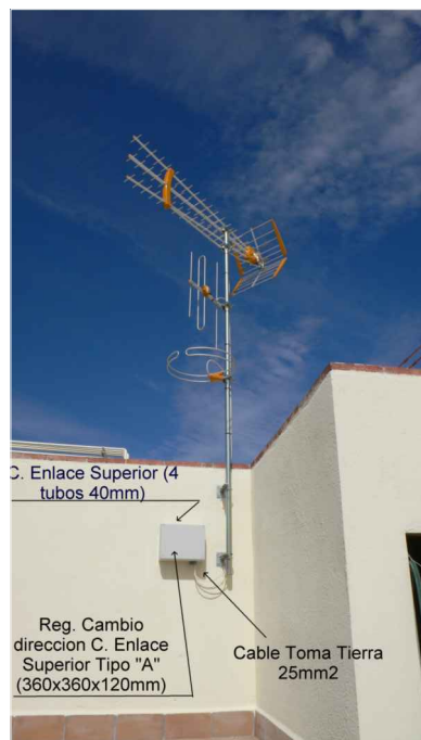
FOTO EJEMPLO ANTENA MASTIL CON GARRAS Y CAJA ESTANCA CAMBIO DE DIRECCION CANALIZACION ENLACE SUPERIOR
