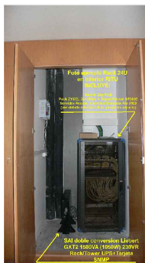
FOTO EJEMPLO DETALLE CCD RACK 19" A800, F800, 24U PARA UBICAR EN RITU (SALA TECNICA)
