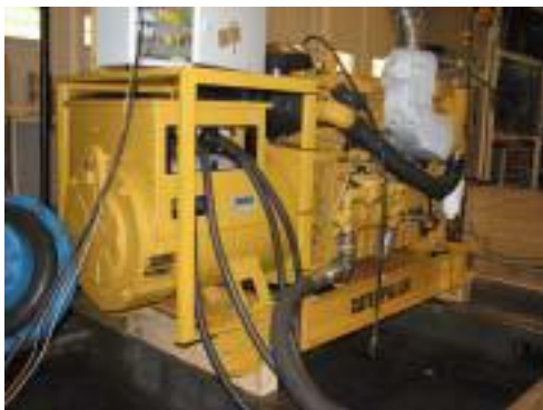
Fot. 4 Współczesny zespół prądotwórczy, mogący sprawować funkcję awaryjnego zespołu prądotwórczego
