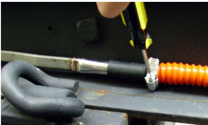
Figure E.3.2 - Orange Conduit Clamping
