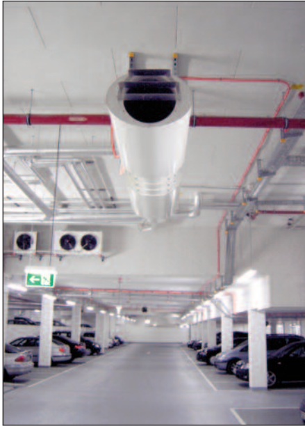
Bild 1: TROX TLT Jet Fan in einer Tiefgarage in Offenbach.
