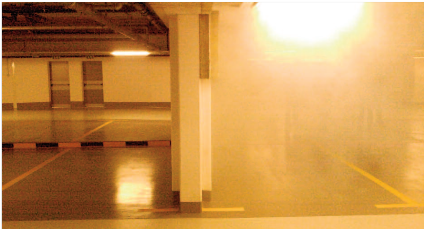
Bild 4: Typisches Beispiel für eine Rauchkontrolle innerhalb einer Tiefgarage in Budapest, Ungarn. Auf die Brandschutzstore wurde auf Grund des Jet-Ventilations-Systems verzichtet.
