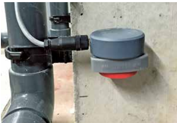
Abb. 7.2.8 Ozonüberwachung im Technikraum
