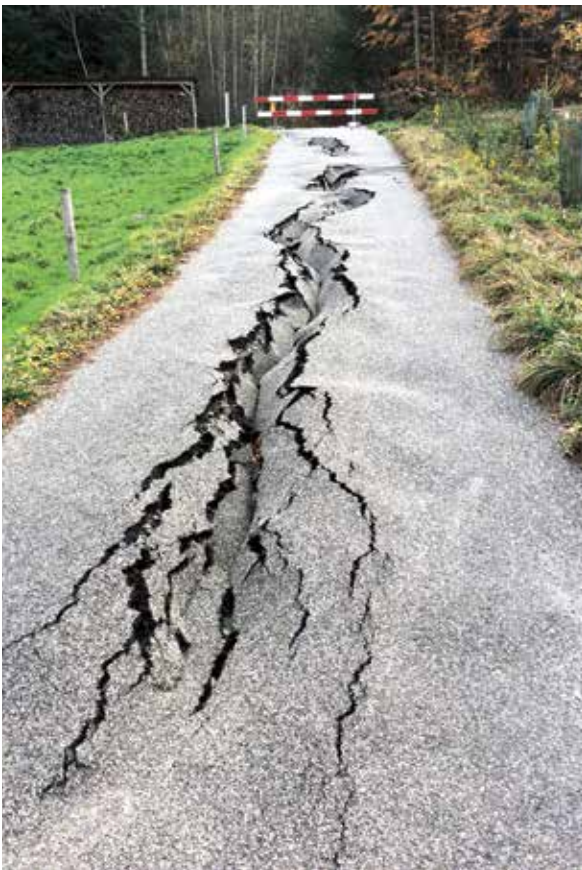
Abb. 7.1.1 Unterspülte Strasse nach Rohrbruch
