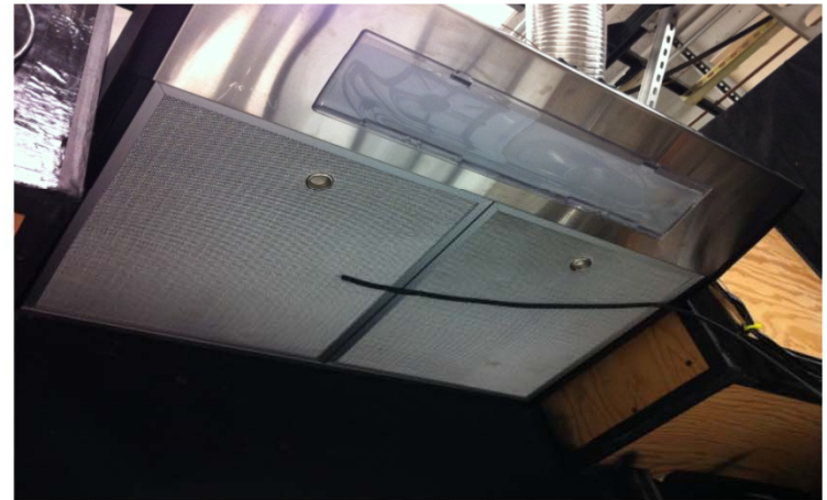
D: Energy Star: no hood
