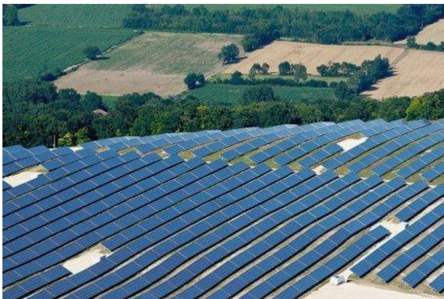
Centrale solaire de saint Clar 334
