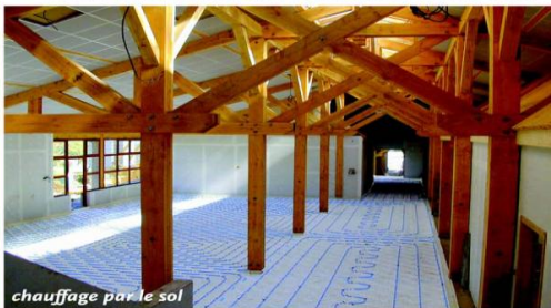
chauffage par le sol
