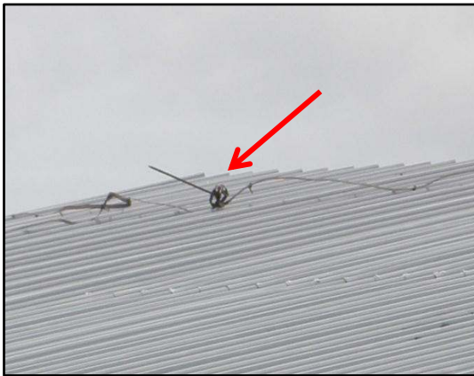
GAMBAR 4.28 Air Terminal Untuk Perlindungan Kilat Telah Tertanggal Di Bumbung
