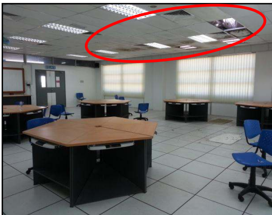
GAMBAR 4.27 Siling Tertanggal Dan Kesan Resapan Air Di Bilik Makmal Yang Tidak Boleh Digunakan
