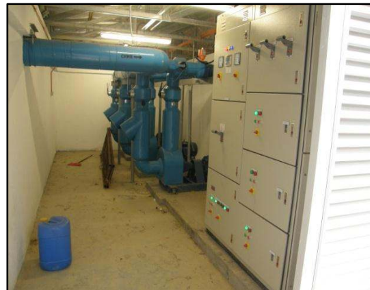
GAMBAR 4.31 Pelapik Getah Tidak Diletakkan Di Atas Lantai Di Hadapan Papan Suis Ruang Chiller Bilik Pam
