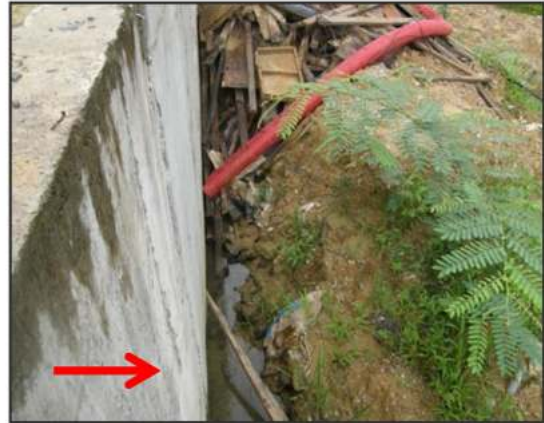
GAMBAR 4.21 Air Bertakung Di Bahagian Bawah Tembok Penahan Dan Boleh Menjejaskan Kestabilan Struktur Tembok Penahan
