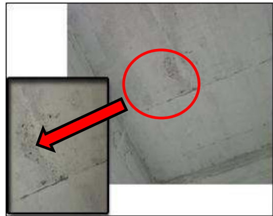
GAMBAR 2.32 Kerja Konkrit Tidak Kemas Di Permukaan Bawah Bumbung Konkrit Indian Shelter
