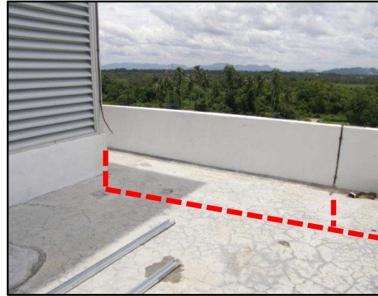
GAMBAR 4.33 Pengalir Perlindungan Kilat Dipasang Di Bumbung Telah Hilang
