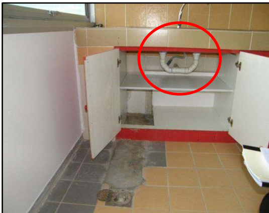
GAMBAR 4.1 Saluran Paip Tidak Dipasang Dengan Perangkap Sampah
