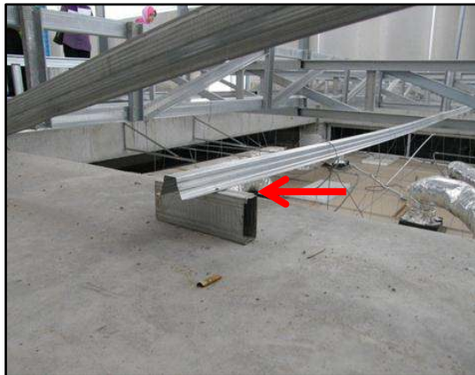
GAMBAR 4.16 Tiada Penyambungan Yang Kukuh Antara Ceiling Joist Kepada Permukaan Lantai
