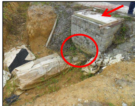
GAMBAR 4.2 Tiada Bukaan Di Lokasi Penyambungan Antara Sump Dan Sistem Swale Serta Penggunaan Konkrit Pada Penutup Sump
