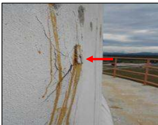
GAMBAR 4.18 Tangki Air Retak
