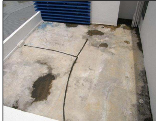
GAMBAR 4.6 Scupper Drain Tidak Direka Bentuk Dan Dibina Lengkap Dengan Outlet Bagi Mengalirkan Air
