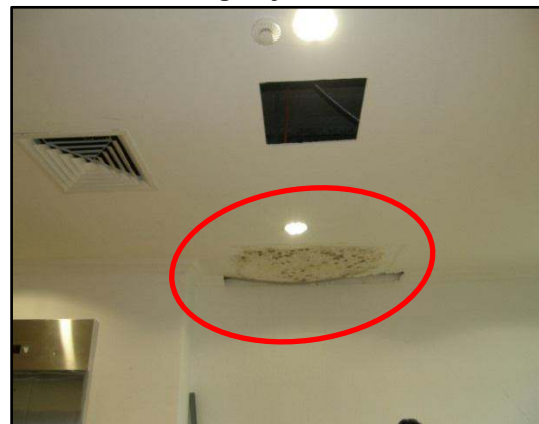
GAMBAR 4.35 Siling Melendut Dan Kesan Resapan Air Pada Siling Pejabat Canselori
