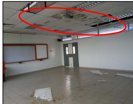
GAMBAR 4.26 Siling Tertanggal Dan Kesan Resapan Air Di Bilik Kuliah Yang Tidak Boleh Digunakan
