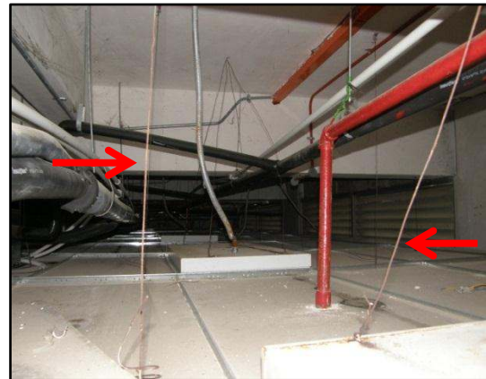
GAMBAR 4.17 Ceiling Hanger Berkarat Di Bahagian Dalam Siling Data Centre
