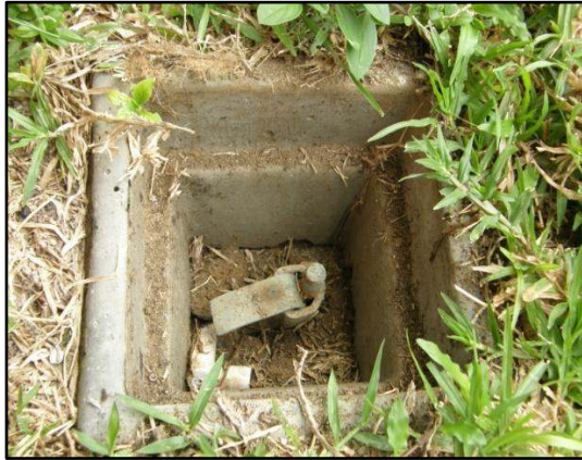
GAMBAR 4.32 Penyambungan Pada Earth Electrode Tidak Menggunakan Kaedah Exothermic Welding
