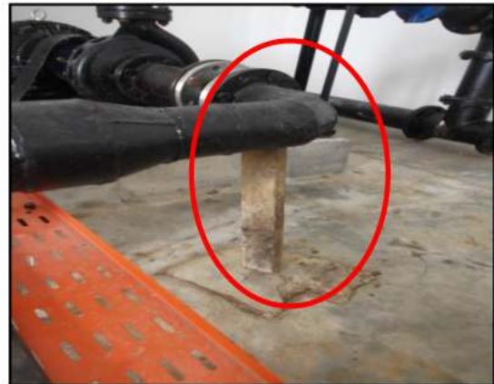
GAMBAR 4.23 Tiada Pemasangan Bracket Yang Sempurna Pada Paip Air Rumah Pam
