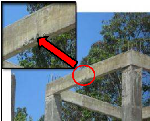
GAMBAR 2.27 Kerja Konkrit Blok Pavillion Tidak Sempurna Pada Struktur Rasuk
