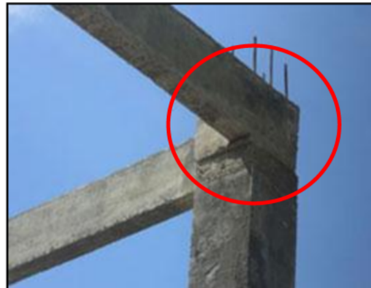
GAMBAR 2.26 Kerja Konkrit Blok Pavillion Tidak Sempurna Pada Struktur Tiang
