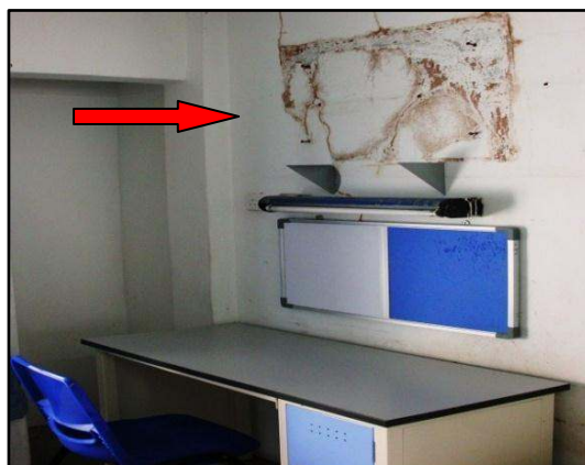
GAMBAR 5.2 Rak Buku Rosak Yang Belum Diganti
