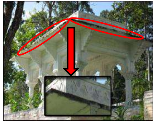
GAMBAR 2.30 Permukaan Sisi Bumbung Konkrit Berkulat Di Indian Shelter
