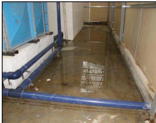
GAMBAR 4.9 Air Bertakung Pada Permukaan Lantai Dan Tidak Dapat Dialir Keluar
