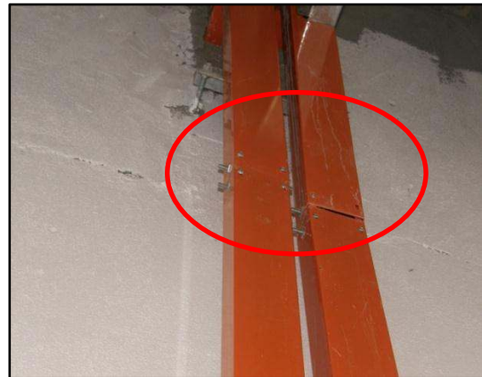
GAMBAR 4.29 Copper Bridge Tidak Dipasang Pada Sambungan Antara Trunking Di Bilik Suis
