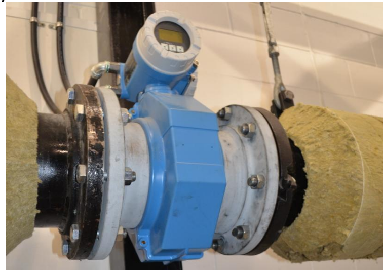
(Serres Demers 2012, St-Nicéphore, Compteur énergétique)
