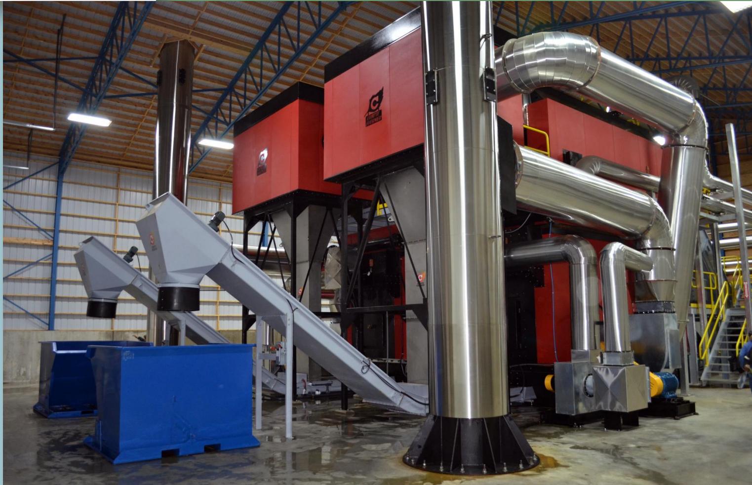
Projet de conversion à la biomasse aux Serres Lefort , 2011 (2x 6000 kW) Réalisation : Jean Gobeil & Associés Inc.
