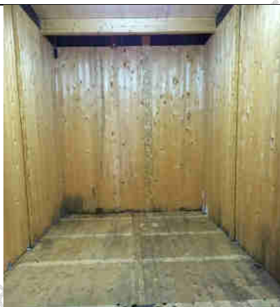
Fig. 5 – struttura XLam: comparsa di ife fungine nell'intorno dei nodi della struttura causa non corretto montaggio delle guaine e smorzatori acustici (courtesy IVALSA)
