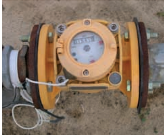
Detalle de caudalímetro
