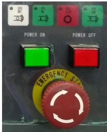
Ilustración 4.4 Paro de emergencia
