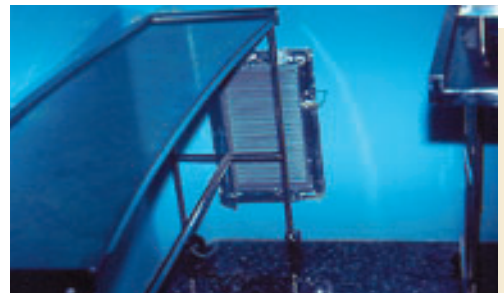
Rejilla de extracción
