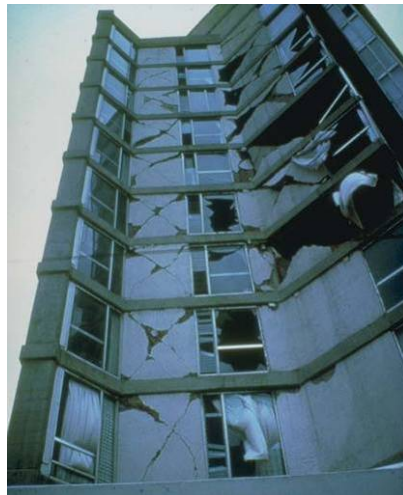
Figura 3.96 Daños en elementos exteriores
