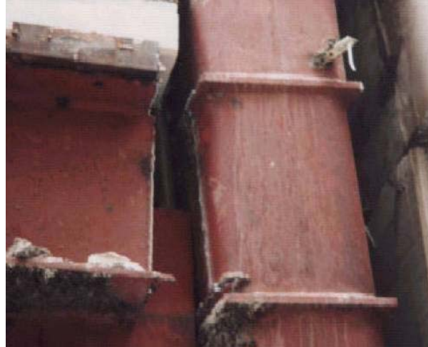
Figura 3.86 Falla de soldadura
