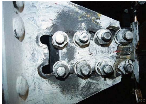
Figura 3.87 Falla de conectores (Foto Ismael Vázquez, 2009)
