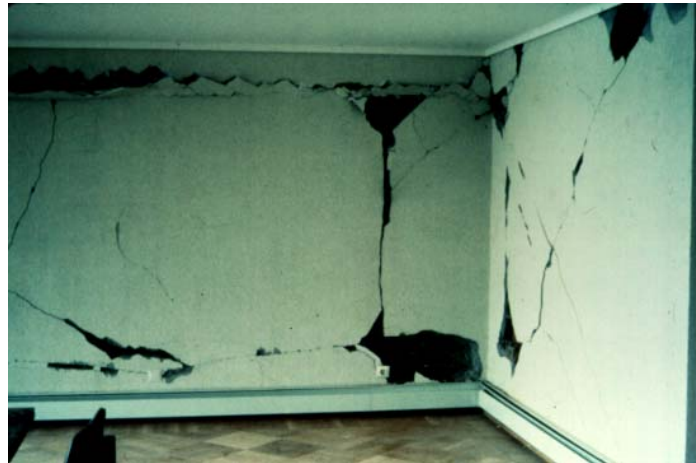
Figura 3.97 Daño en uros divisorios
