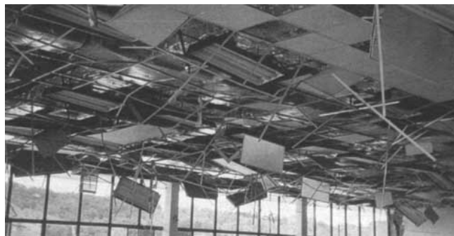
Figura 3.98 Daño en cielos rasos
