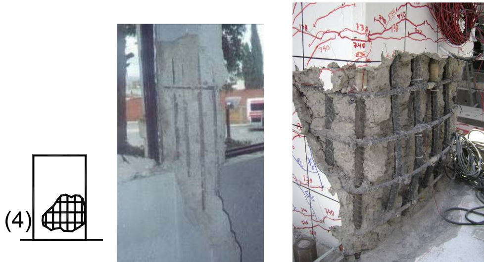
Figura 3.80 Desprendimiento del concreto y acero de refuerzo expuesto
