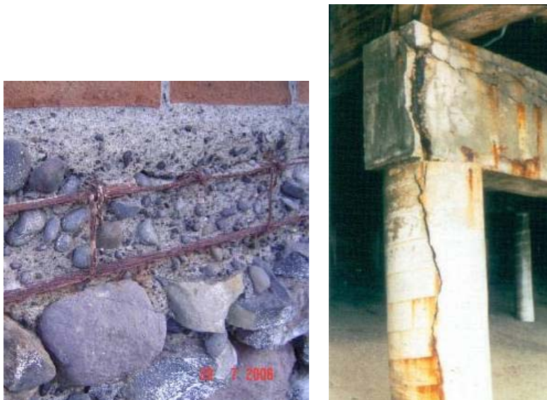
Figura 3.88 Corrosión del acero y deterioro de materiales
