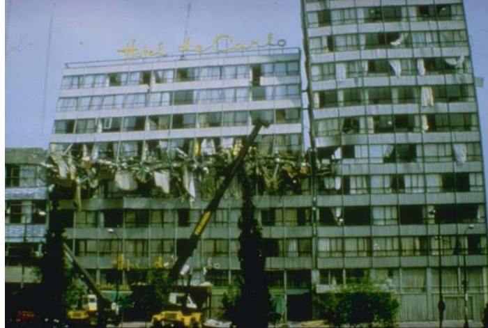
Figura 3.76 Daños por choque con el edificio vecino
