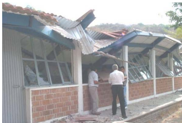
Figura 3.89 Colapso de techo
