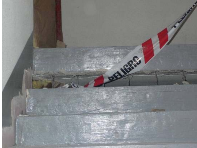
Figura 3.99 daño en escaleras
