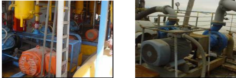
Fig 1. Motores Eléctricos conectados un compresor de refrigeración y a bombas centrifugas
