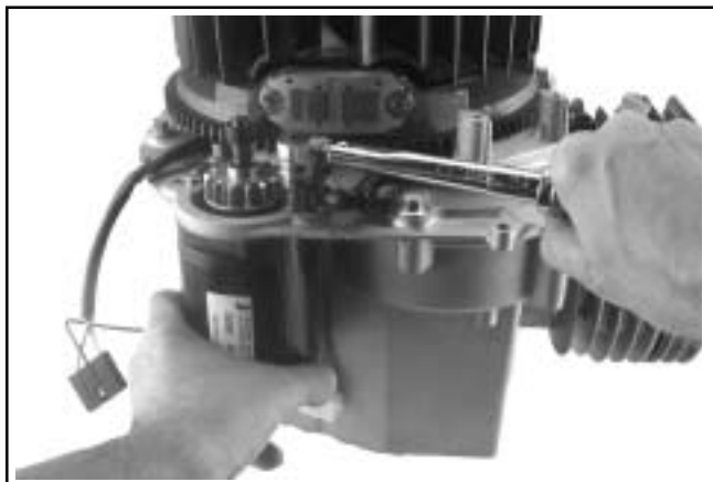
Figura 10-47. Installazione del motorino di avviamento elettrico.
