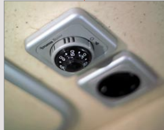
Bedieneinheit Boiler (Decke)
