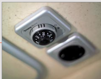
Boiler einschalten (Decke)
