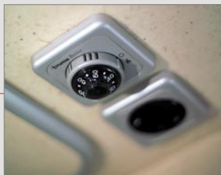
Boiler einschalten (Decke)
