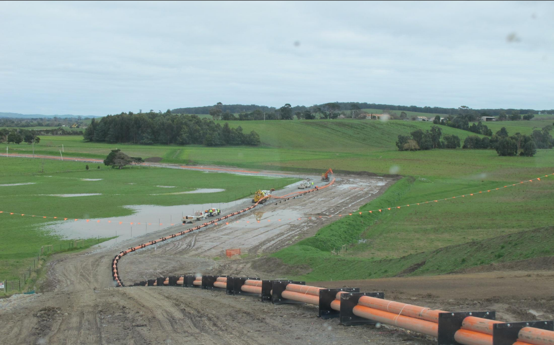
Cross country electrical conduit
